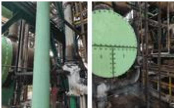
Gambar 6. Instalasi Modifikasi Perpipaan.
