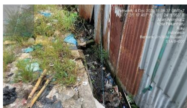
Gambar 1. Kondisi Drainase di Jl. Sido Rukun 1
